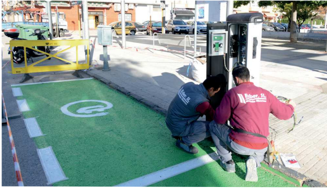
Punt de recàrrega de vehicles elèctrics. L'Ajuntament ha instal·lat el primer punt de recàrrega públic de vehicles elèctrics, a la Plaça 3 d'Abril.
